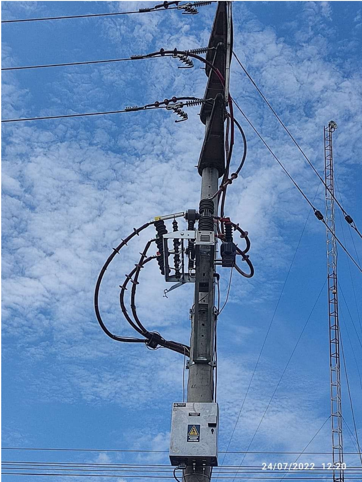
FOTO DE EQUIPOS MONTADOS EN POSTE
